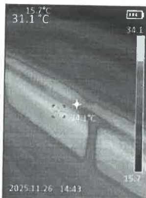
Рис. 2. Термограмма оконного блока аудитории 4411. В нижней части рамы и зоне примыкания к откосу наблюдается темно-синяя зона с минимальной температурой +15,7 °С (при фоновой температуре стены ~20,0 °С, \Delta T = 4,3 °С), что указывает на значительную инфильтрацию холодного воздуха и серьезный дефект монтажного шва
