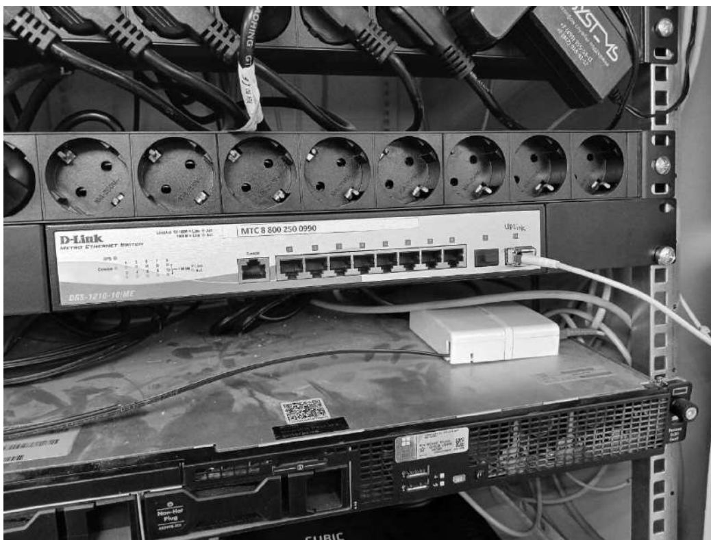
Рис. 5. Фотоотчетность по установке коммутатора
