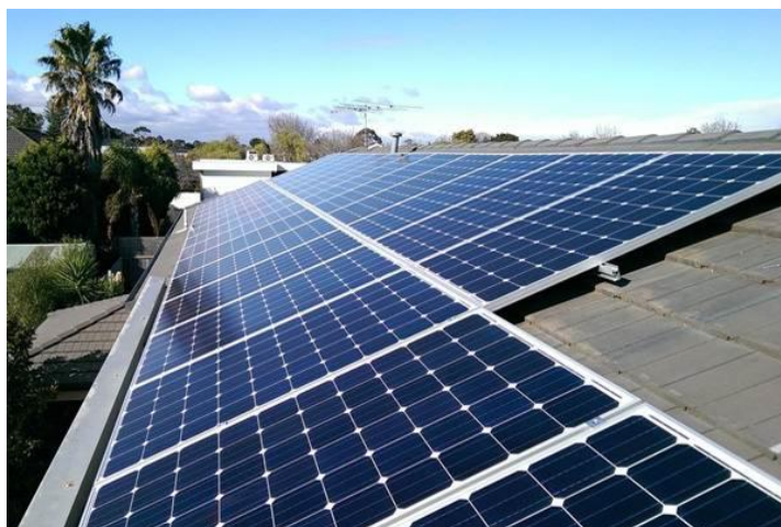
Рис. 1. Солнечная электростанция на крыше дома
