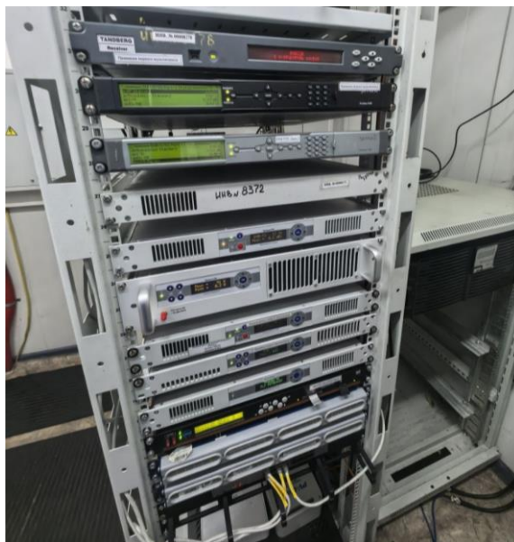
Рисунок 23 - Блок передатчика на объекте в Раздольном
