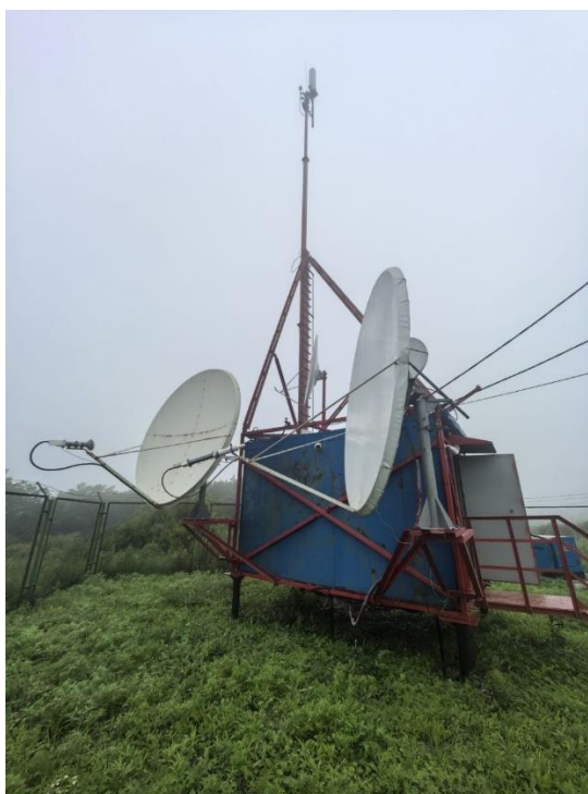
Рисунок 25 - Общий вид оборудования в Раздольном
