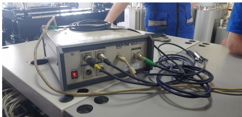
Рисунок 10 - подключение контрольного оборудования
